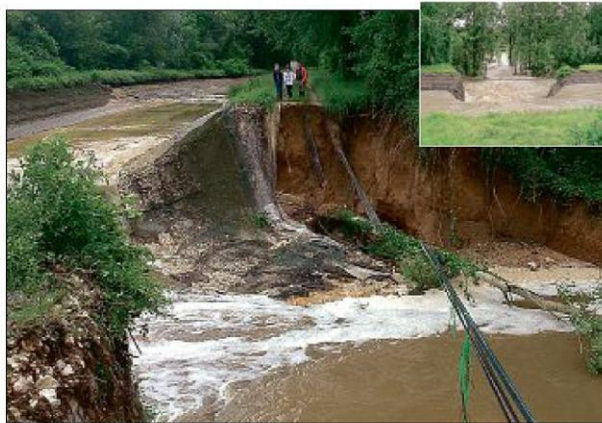
LA DIGUE CÈDE. Le point de rupture de la digue du canal à la sortie de Montresson. En médaillon pendant les inondations, puis ci-dessus quelques jours après.
